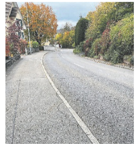
Muss erneuert werden: Schiedhaldenstrasse. BILD A
